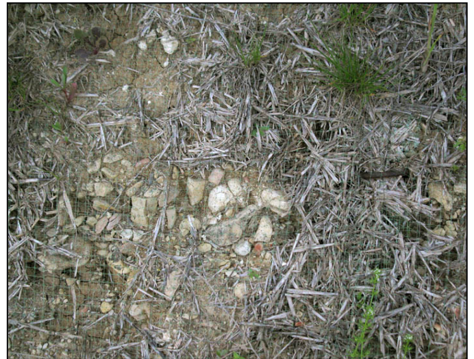
fenomeni di erosione delle biostuoie
