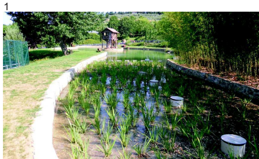
1 - Zona di fitodepurazione
