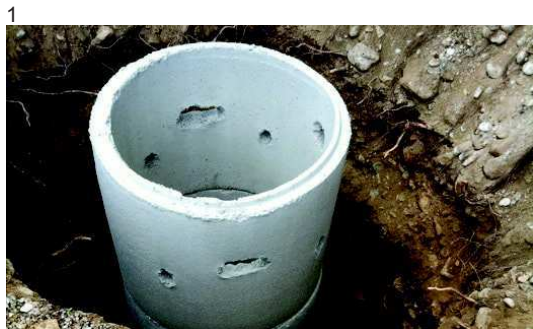
1 - Pozzo perdente in cls
